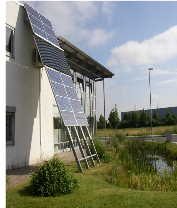
Pilot-Projekt auf der Loddenheide: Photovoltaik-Anlagen und Sonnenkollektoren gehören ebenso zur Öko-Ausstattung wie Regenwasserteiche mit insgesamt 50.000 Liter Fassungsvermögen.
